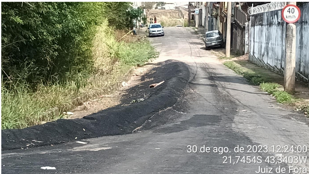
Foto 7 - Vista da Rua Antônio Alves Teixeira, com sinais evidentes de abatimento da rua entre a crista da encosta e a leira.
