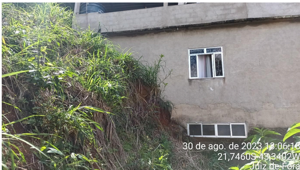
Foto 20 - Fundos de edificação da Rua Rosa Sffeir, executada com escavação do pé do talude.
