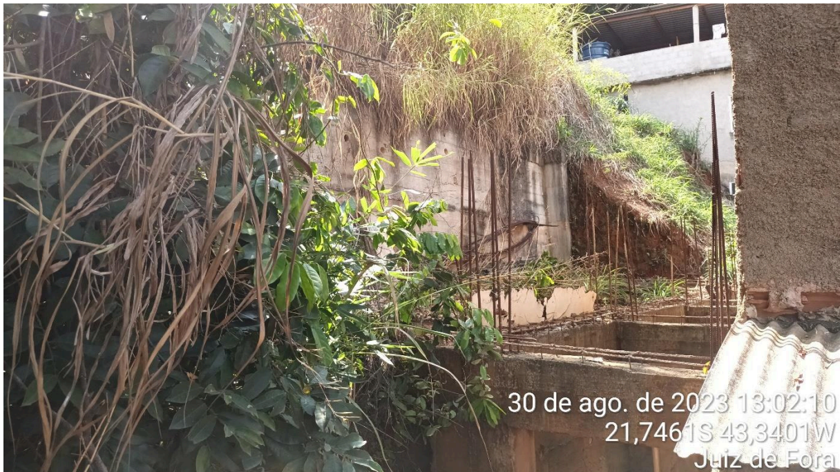
Foto 19 - Estruturas precárias de contenção implantadas nos fundos da edificação da Rua Rosa Sffeir, onde houve escorregamento pretérito após escavação do pé do talude.
