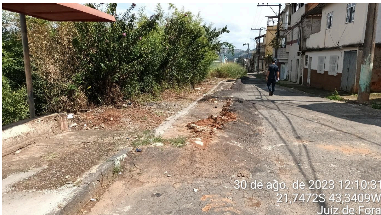
Foto 21 - Leira de saco de solo e material asfáltico na Rua Miguel Jacobe, localizada ao final da Rua Antônio Alves Teixeira, no trecho onde houve escorregamento translacional pretérito do talude.
