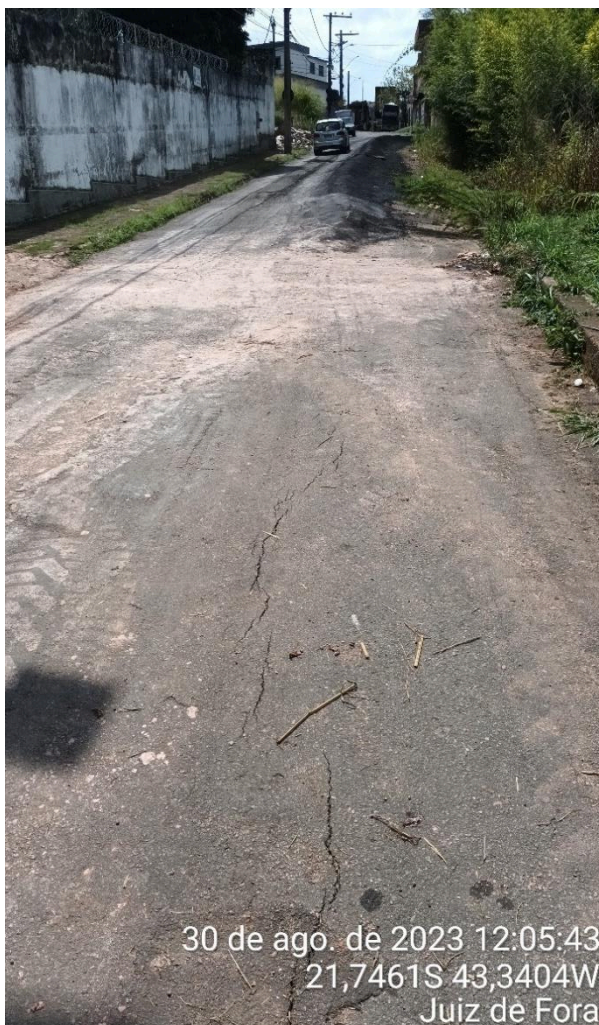
Foto 9 - Trincas no pavimento.
