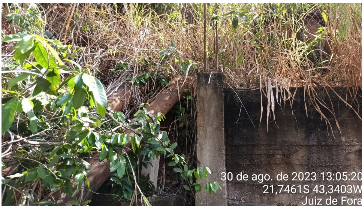
Foto 17 - Tubulações de ferro fundido de recalque e de abastecimento de água aparentes no talude.
