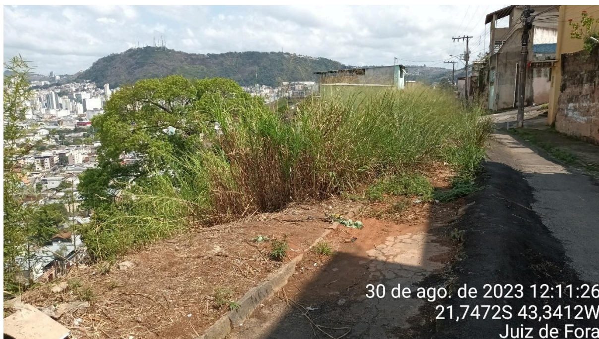
Foto 22 - Leira de saco de solo e material asfáltico na Rua Miguel Jacobe, localizada ao final da Rua Antônio Alves Teixeira, no trecho onde houve escorregamento translacional pretérito do talude.
