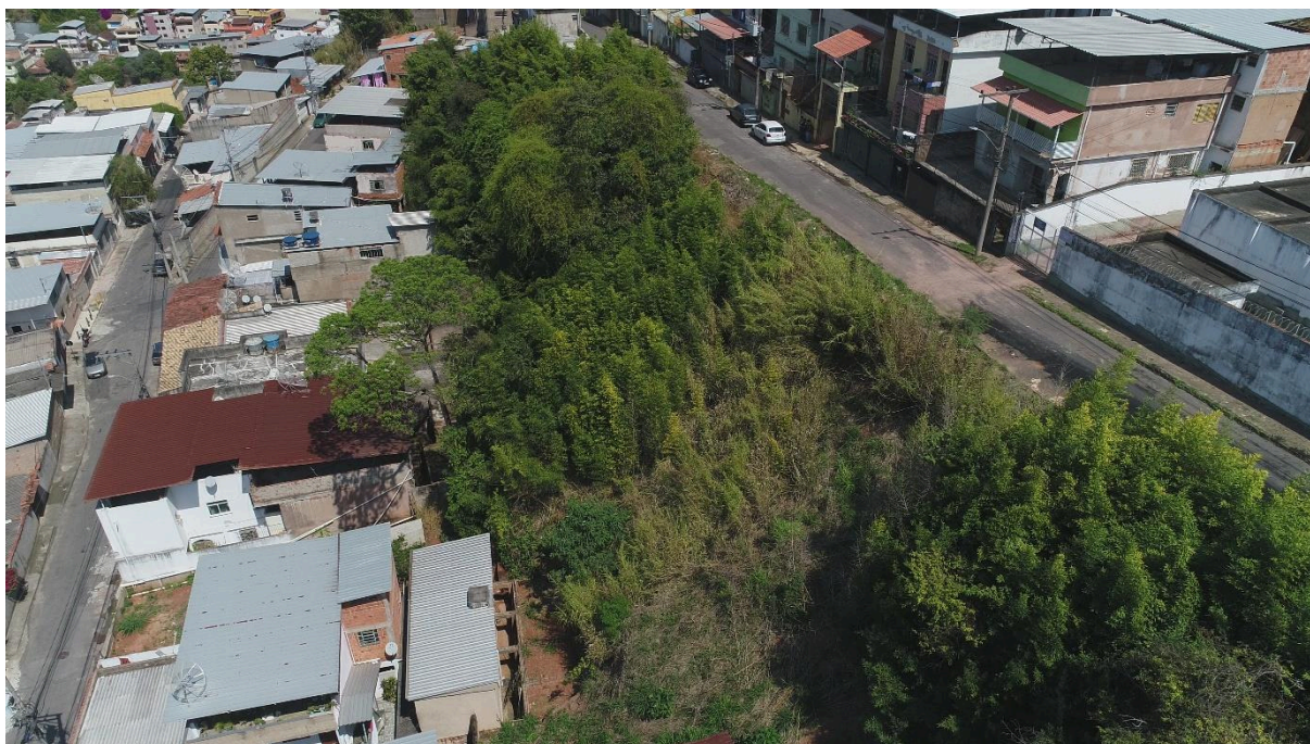
Foto 16 - Talude a jusante da Rua Antônio Alves Teixeira, onde tubulações de ferro fundido de recalque e de abastecimento de água estão posicionadas de forma esconsa.
