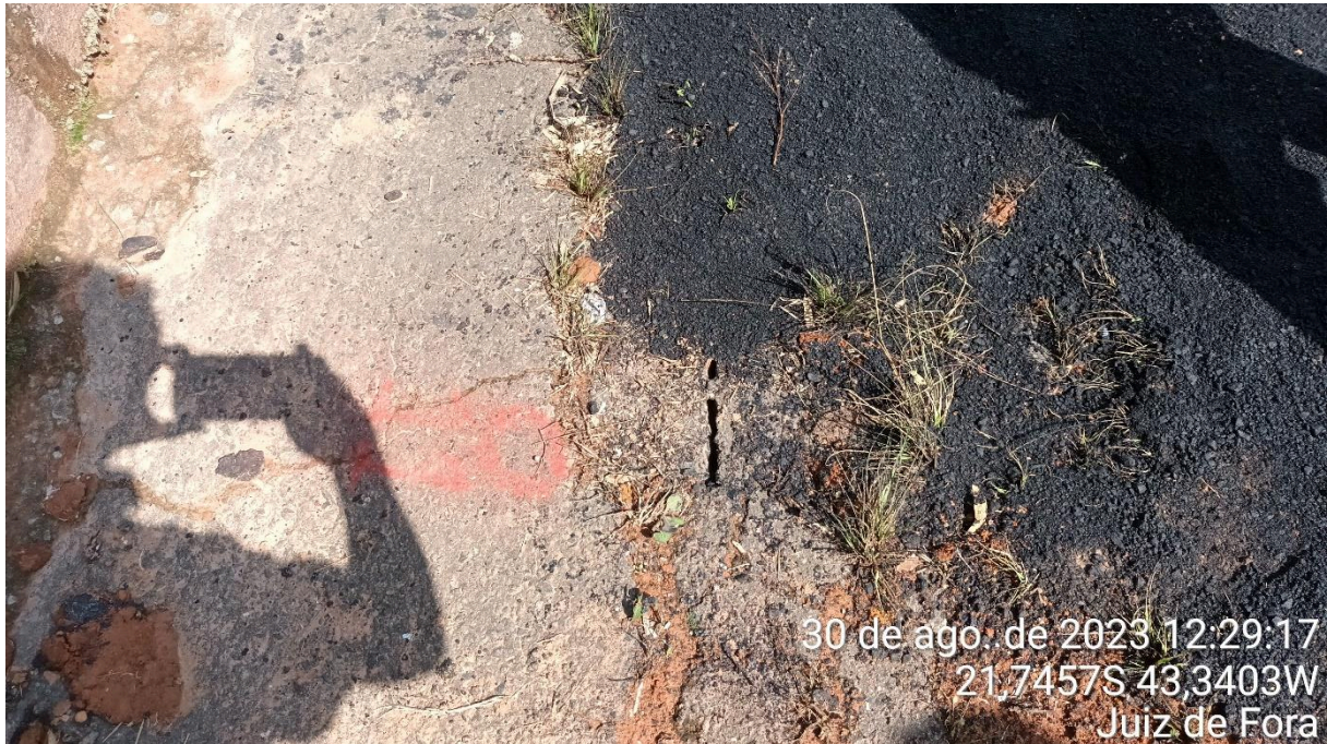
Foto 8 - Trinca no pavimento.
