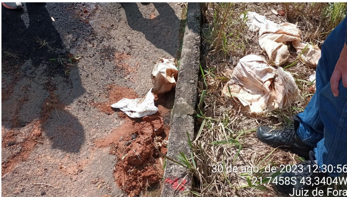
Foto 10 - Abertura entre a guia e o terreno, evidenciando movimentação horizontal do maciço.
