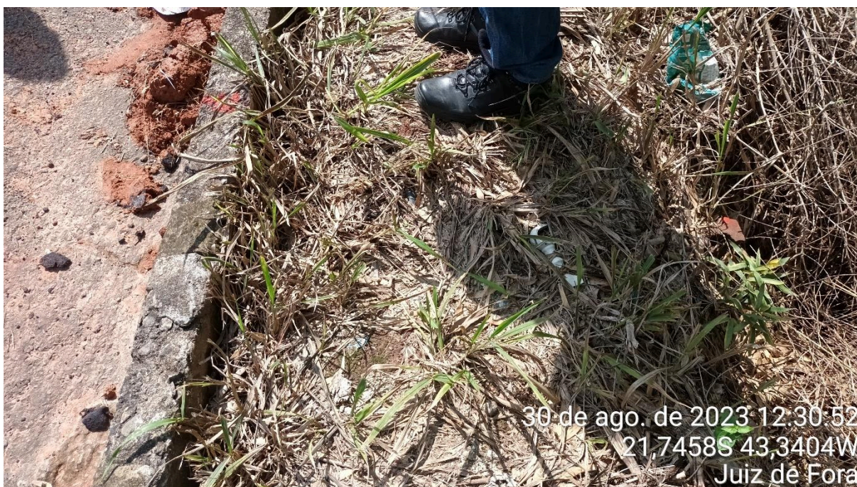
Foto 11 - Abertura entre a guia e o terreno, evidenciando movimentação horizontal do maciço.
