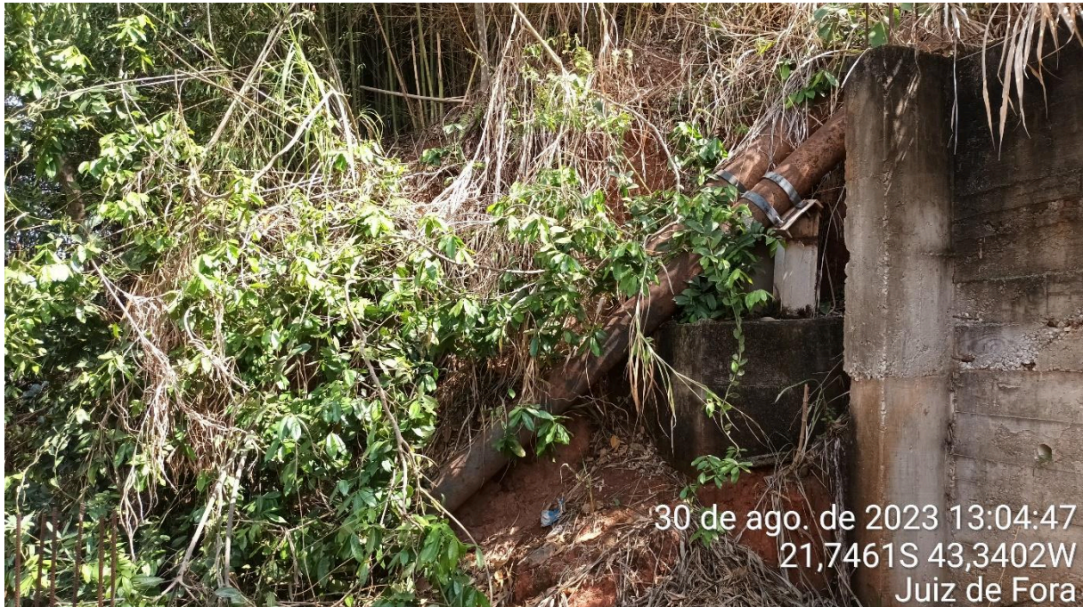
Foto 18 - Tubulações de ferro fundido de recalque e de abastecimento de água aparentes no talude.
